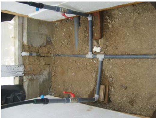
Fig.28. Tubos alimentadores con llaves independientes para cajones angostos
