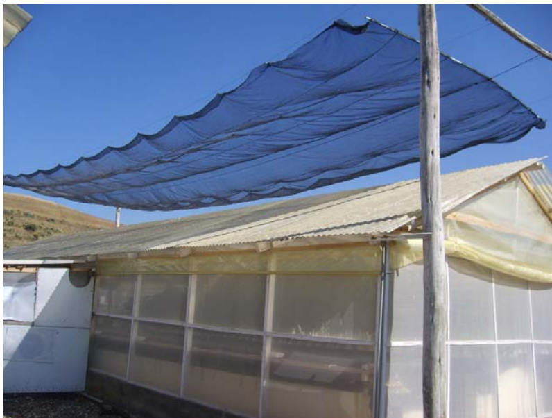
Fig.12. Invernadero con diferente tipo de instalación de malla sombreadora. Esta instalación permite sombrear solo cuando hay excesivo calor.
