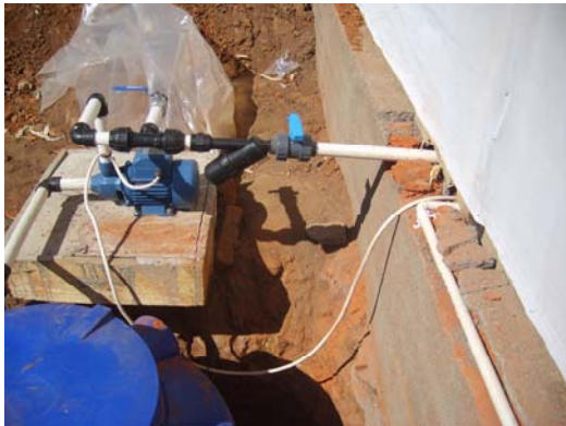
Fig. 26. Instalación externa del tanque y bomba. Nótase el filtro entre las 2 llaves de color celeste.
